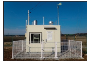
広域モニタリングステーション
