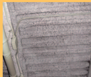
石綿含有吹付けロックウール (天井断熱材)
