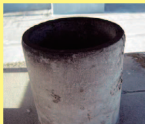
石綿含有断熱材 (煙突用断熱材)
