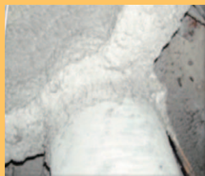
吹付け石綿 (鉄骨耐火被覆材)
