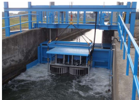
設置例：内川小水力発電所（大崎市）
