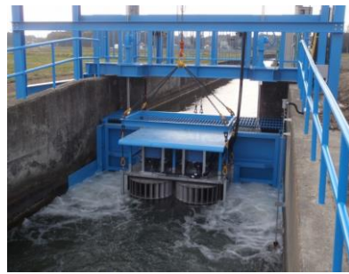
モデル実績：内川小水力発電所(大崎市)
