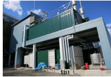
木質バイオマス発電プラント
