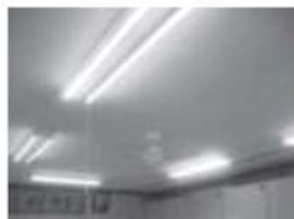
LED照明設備の導入例
