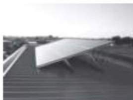
太陽光発電設備の導入例
