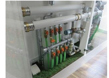
地中熱利用設備
