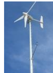
風力発電設備
