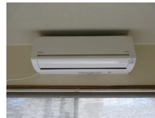
高効率空調機
