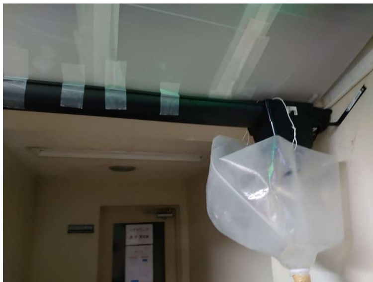
写真 12 雨漏りの補修箇所例 1
