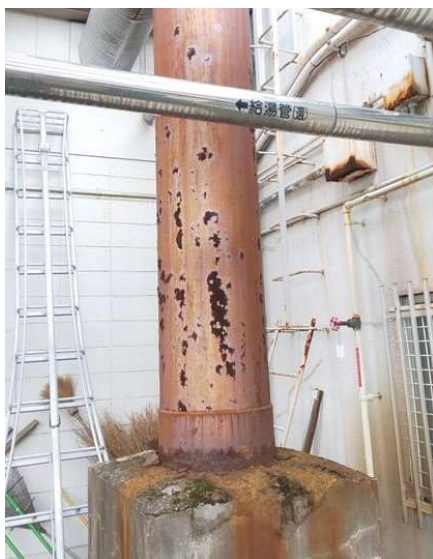
写真 5 ボイラー煙突部
