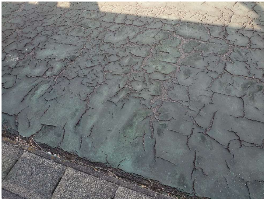
写真8 ハードコートのクラック
