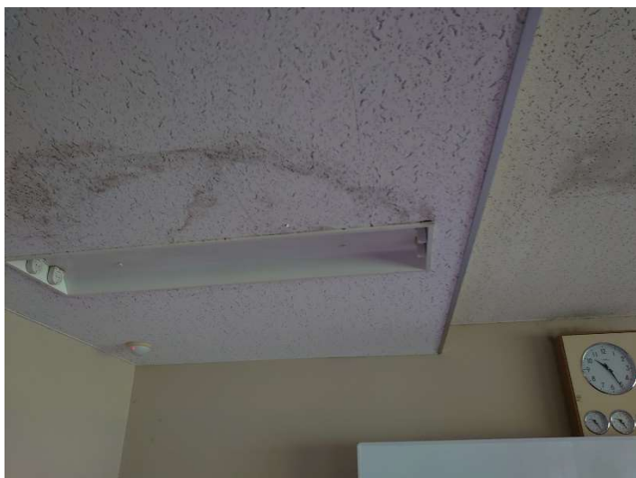
写真 14 雨漏りによって生じたシミ
