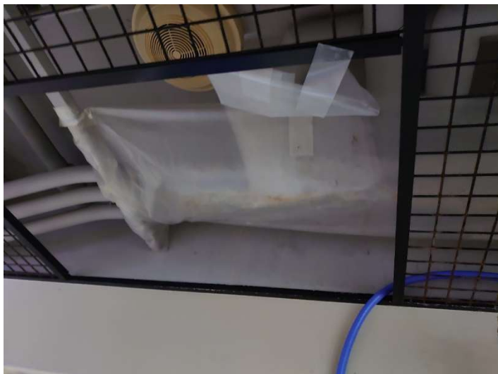
写真 13 雨漏りの補修箇所例 2
