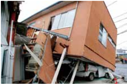
倒壊した建物
