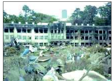
津波と火災による被害を受けた 石巻市立門脇小学校
