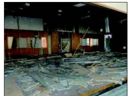
天井等が激しく損傷した県武道館弓道場
