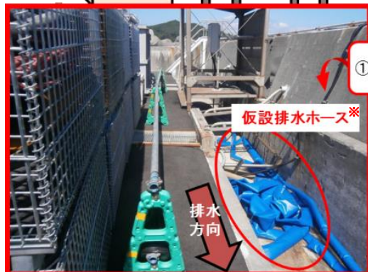
事象発生翌日の現場状況
