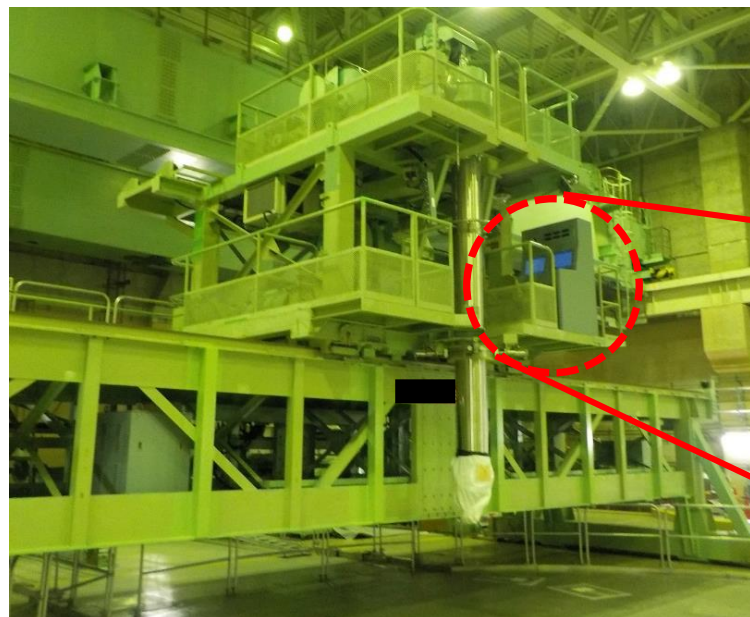
燃料交換機 全景写真
