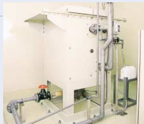
放水口モニター(2号機)
