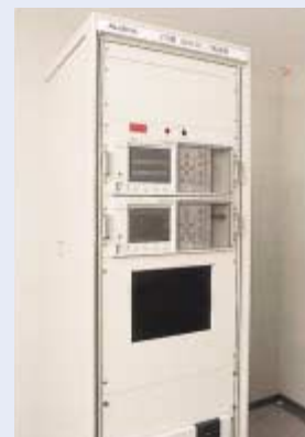
放水口モニター監視盤(2号機)
