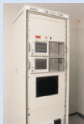
放水口モニター監視盤(2号機)
