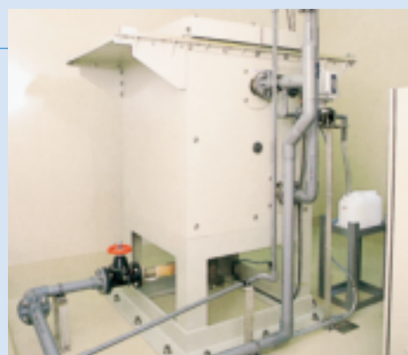
放水口モニター(2号機)
