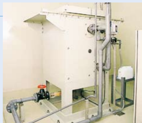
放水口モニター(2号機)
