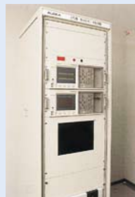
放水口モニター監視盤(2号機)
