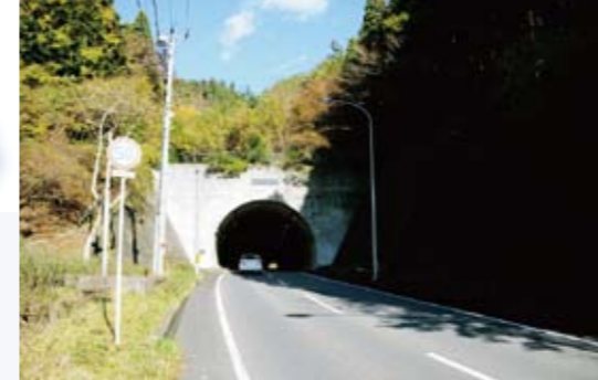
【新小積トンネル】小積浜から小網倉浜に至る小積峠をショートカットするためにつくられた新小積トンネルは、1988年3月に完成した。延長470mのトンネルによって、それまで細く曲がりくねった山道を通ることなく、旧石巻市と旧牡鹿町をスムーズに往来できるようになった。
