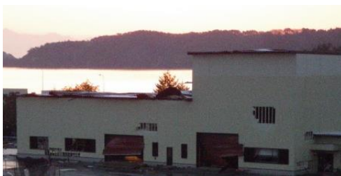
建屋壁材の剥がれ状況
