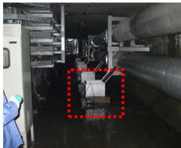
旧水位計収納箱から海水が流入 (対策前)
