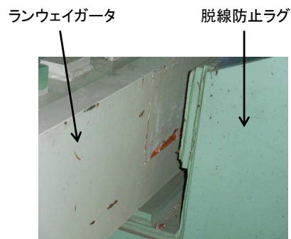
脱線防止ラグ接触状況
