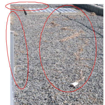
写真B 敷砂利上に残留した塵芥
