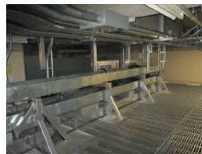
区分Ⅱケーブル処理室
