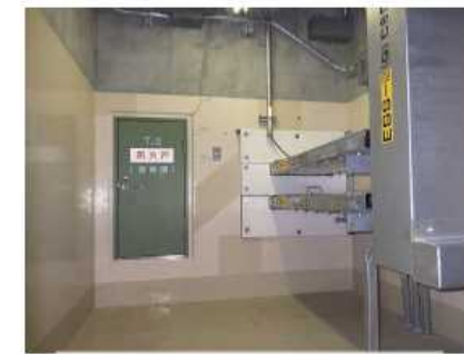
区分Ⅲケーブル処理室
