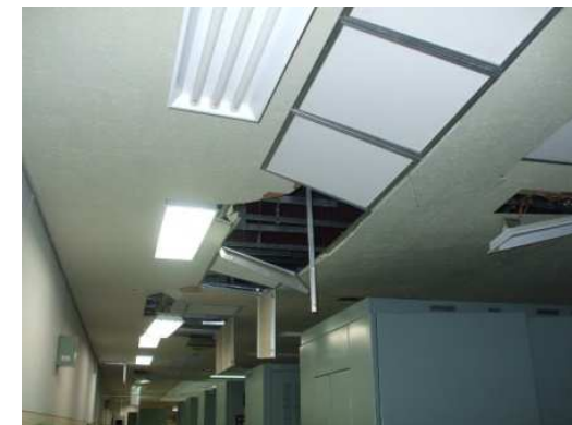
天井の被害例(3.11地震時中央制御室)
