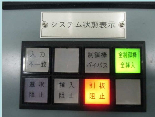
全制御棒全挿入ランプ
