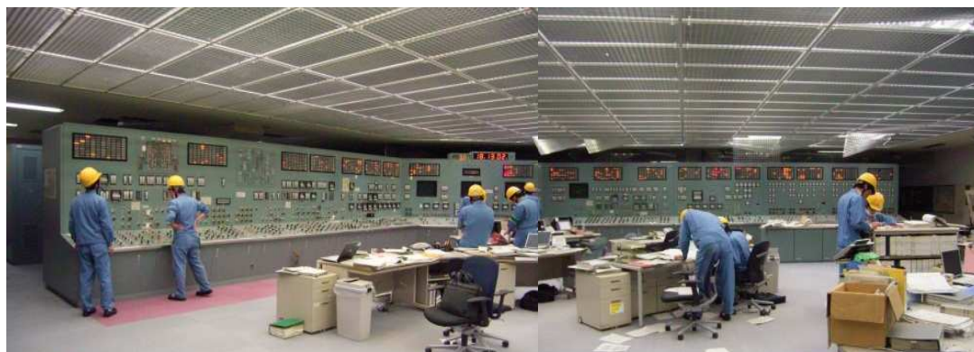
震災時の中央制御室の様子
