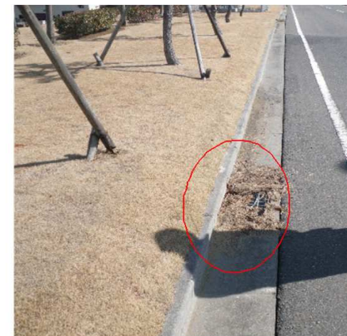
写真A 構内道路に残留した塵芥
