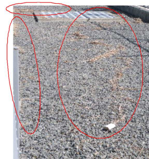
写真B 敷砂利上に残留した塵芥
