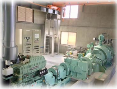
▲十五貫排水機場ポンプ設備の様子
