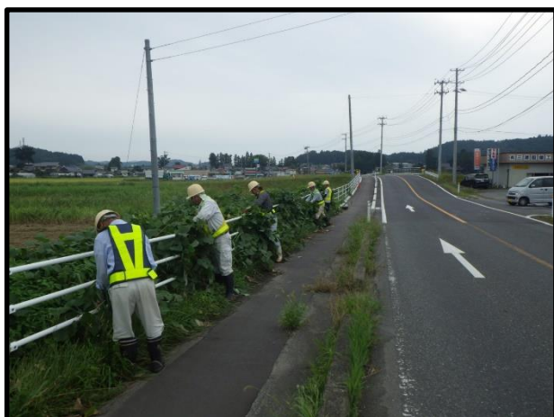
団体名：宮城建設(株)【ロード】 実施日：H30.9.7 箇所名：(主)栗駒岩出山線 活動内容：除草作業
