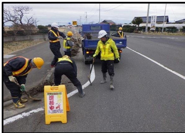
団体名：上田建設(株)【ロード】 実施日：H30.3.16 箇所名：(一)若柳花泉線 作業内容：若柳小学校交差点付近の清 掃作業
