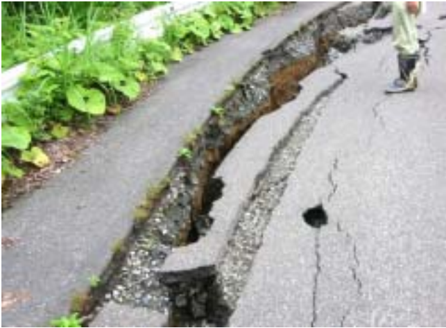
道路亀裂及び段差
