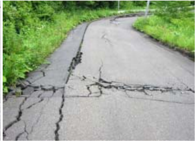
道路亀裂及び段差
