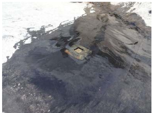
●3 ゴムシート欠損
