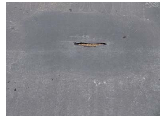
●5 ゴムシート裂け目
