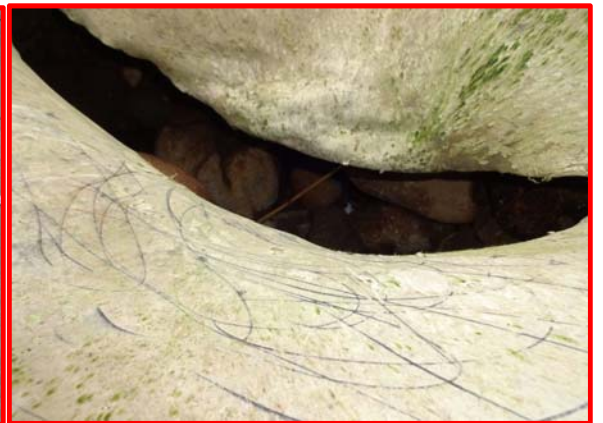
ピンホールが拡大し、裂け目となった
