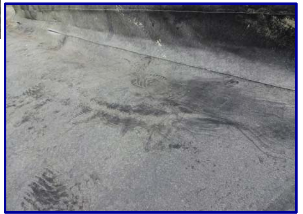
水圧により伸びて たわんだゴムシート
