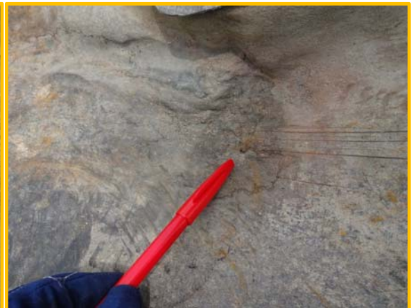
伸縮限界を超えて生じたピンホール
