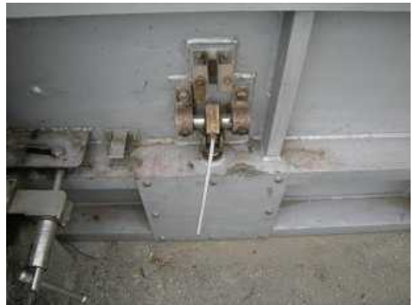
門扉上下化用レバーの曲がり状況
