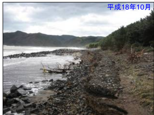
【捨石護岸・保安林の被災状況】
