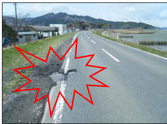
路面に穴があいたり路肩が壊れている
