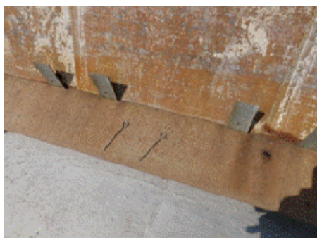
図 4.1.7 ウェザーシールのはずれ
