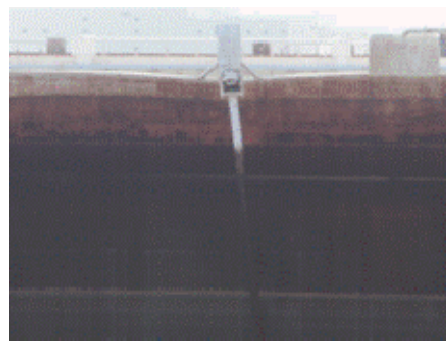
図 4.1.6 浮き屋根回転止め，側板の変形
