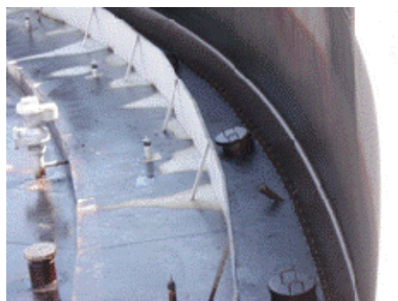
図 4.1.7 ポンツーン蓋の離脱
