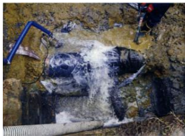
志波姫ポンプ場前圧送管 漏水状況
