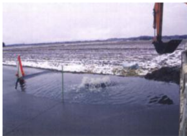
志波姫ポンプ場上流人孔の溢水状況
