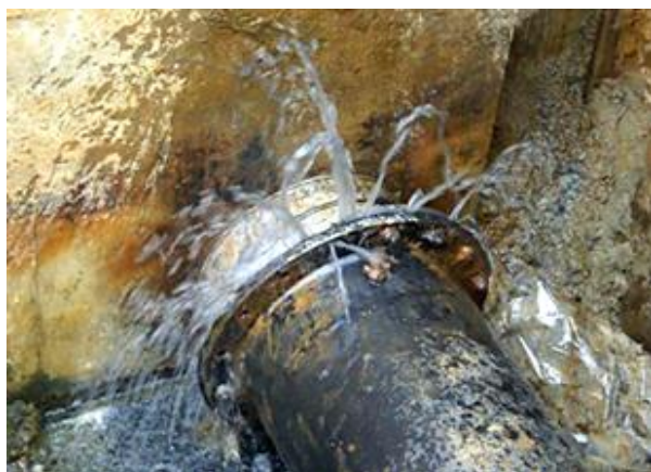
若柳第1ポンプ場内圧送管 漏水状況
