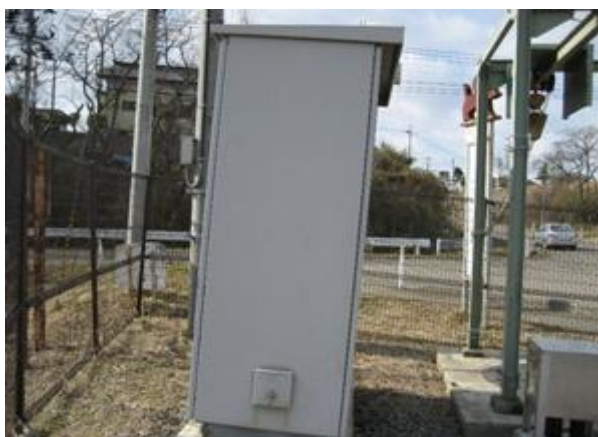
栗駒第2ポンプ場受電盤 沈下状況
