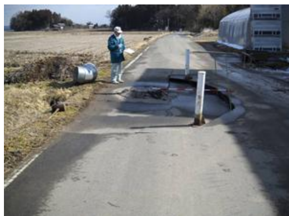
迫川右岸幹線マンホール 陥没状況
