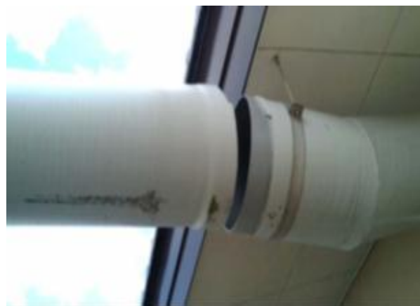
石越浄化センター排気ダクト管 破損状況
