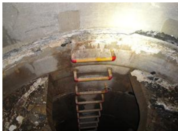
迫川左岸幹線マンホール内部 破損状況
