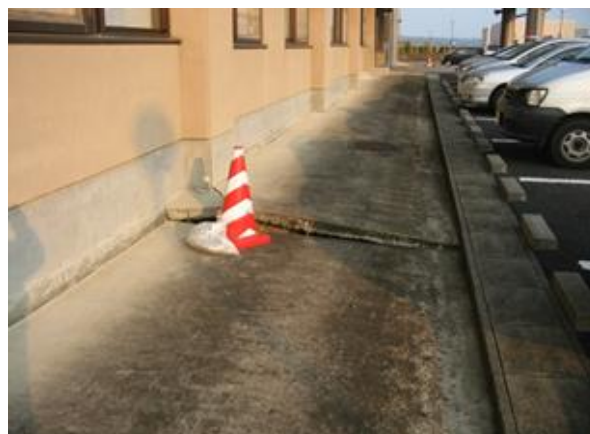
石越浄化センター土間コンクリート 沈下状況
