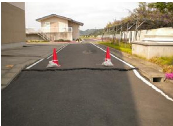
石越浄化センター場内舗装 段差発生
