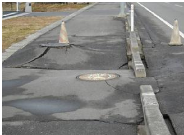
迫川右岸幹線マンホール 隆起状況
