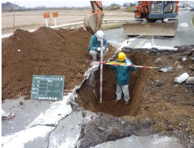
クラック(亀裂)に石灰水を流し込み、石灰の跡をたどりながら掘削して、クラックの深さや方向を調べます
