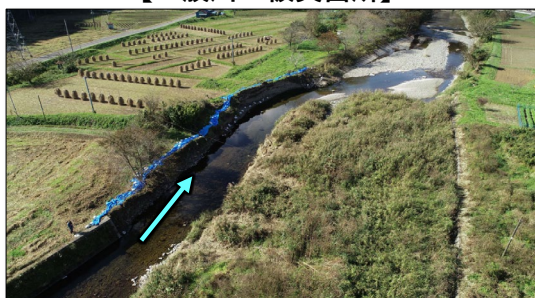
【二股川・被災箇所】
