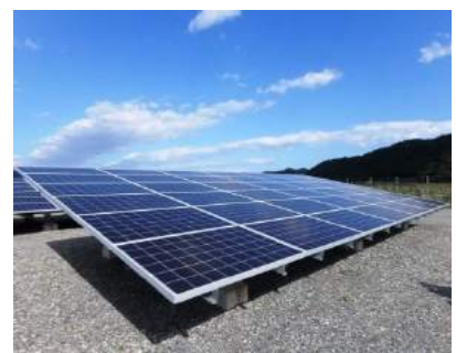
▲太陽光パネル
