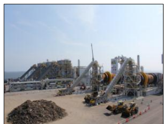
焼却炉稼働時の状況 (石巻ブロック)
