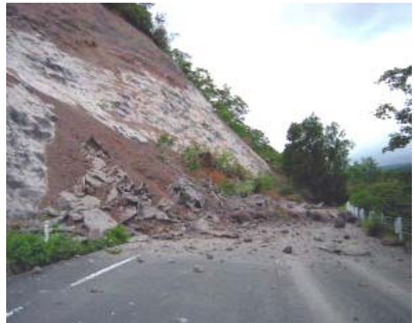
国道 398 号 栗原市花山湯浜付近 法面崩落状況
