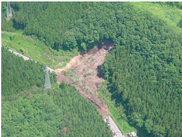
国道 398 号 栗原市花山松ノ原地区 法面崩落状況
