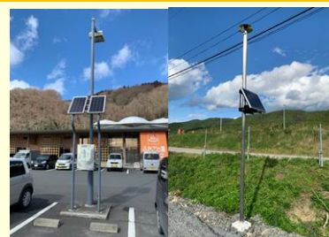
駐車場用街路灯
