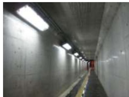
白石トンネル 歩道部 照明
