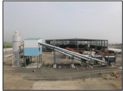
練混ぜ施設 (バッチャープラント)
