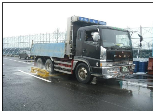
写真9-9 タイヤ洗浄装置
