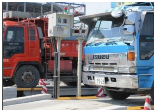
写真8-16 トラックスケール
