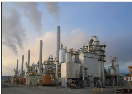
写真8-22 焼却施設全景（焼却炉5基）
