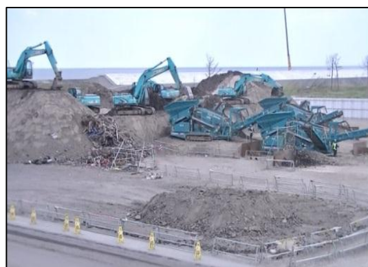
写真8-25 津波堆積物処理設備
