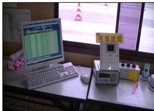
写真8-14 搬出入計量システム
