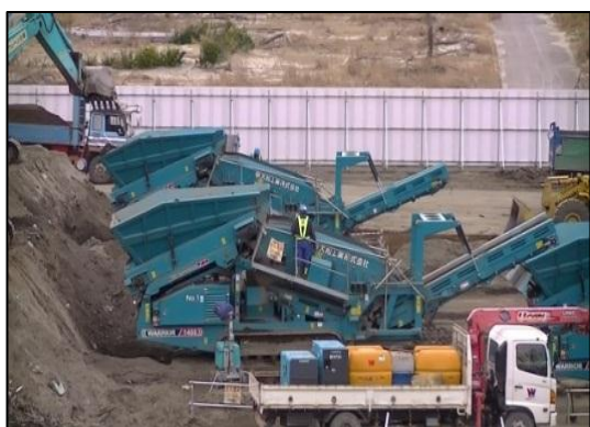
写真8-24 津波堆積物処理設備
