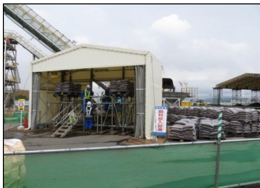
写真4-35 廃飼料投入施設
