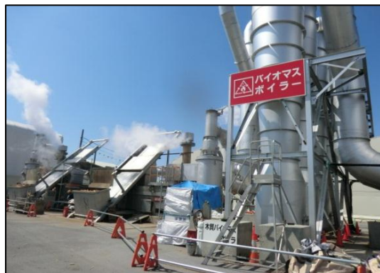
写真4-26 バイオマスボイラー
