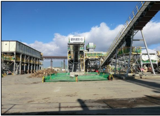
写真4-21 破砕選別施設
