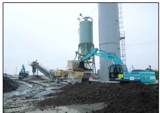
写真4-30 汚泥不溶化・固化施設（リテラ）
