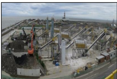
写真4-27 土質改善施設 (汚染なし改質・汚染あり改質不溶化)
