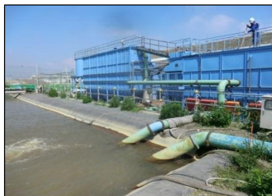
写真4-39 排水受水 濁水循環施設
