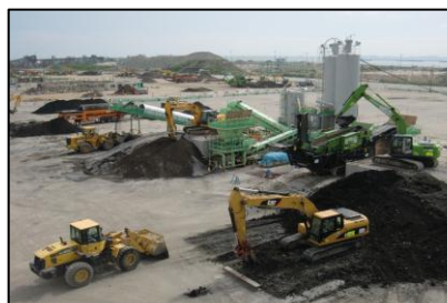
写真4-28 回転式破碎混合 (ツイスター)施設
