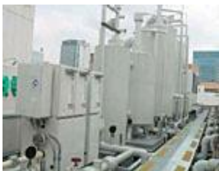
コージェネレーションシステム
