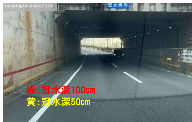
▲写真② 浸水深のライン
