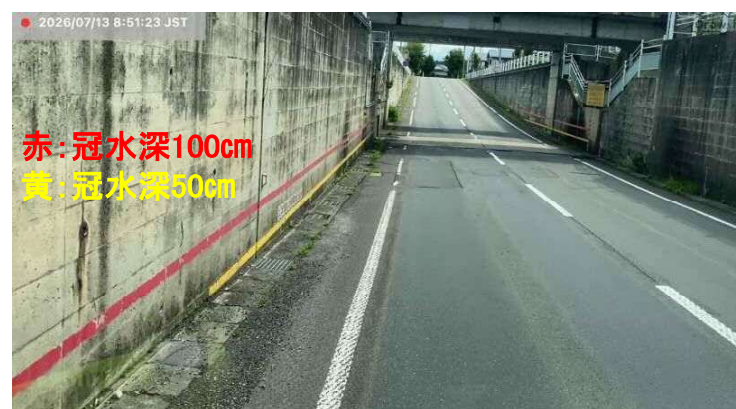
▲写真① 浸水深のライン
