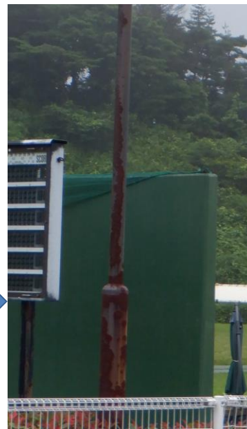
ポール発錆状況(一部拡大)
