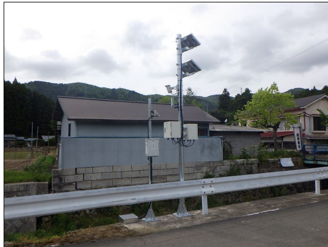
真野川 水位計 (新明治橋)
