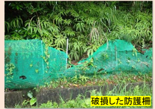
破損した防護柵
