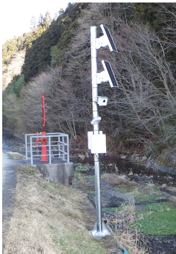
監視カメラ 設置状況(折立川)
