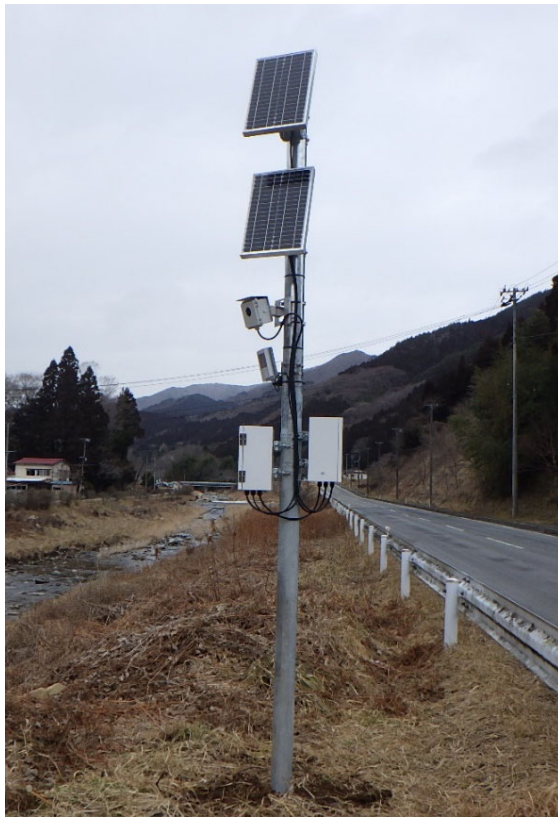
監視カメラ 設置状況(津谷川)
